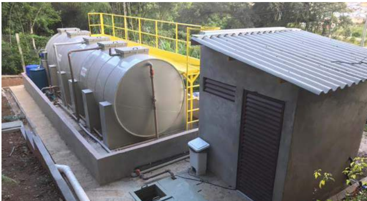
Estação de Tratamento de Efluentes do Hospital São Roque
